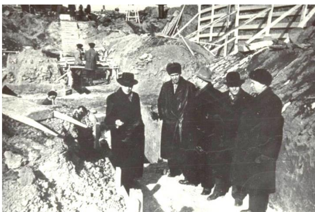
Руководство института осматривает котлован главного корпуса Иркутского института органической химии СО АН СССР Фото из архива института
