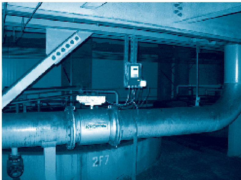
Рис. 2. Измерение расхода сточных вод в частично заполненном трубопроводе DN 400 с использованием TIDAFLUX 4110PE.
