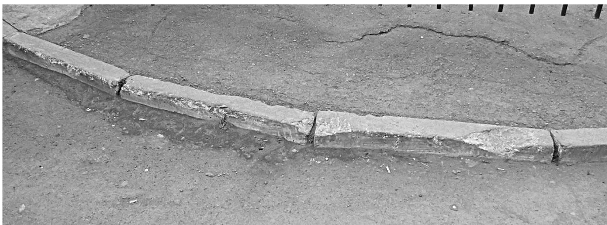
Рис. 3. Пример разрушения фронтальной части бордюра (1280x467 пикселей)
