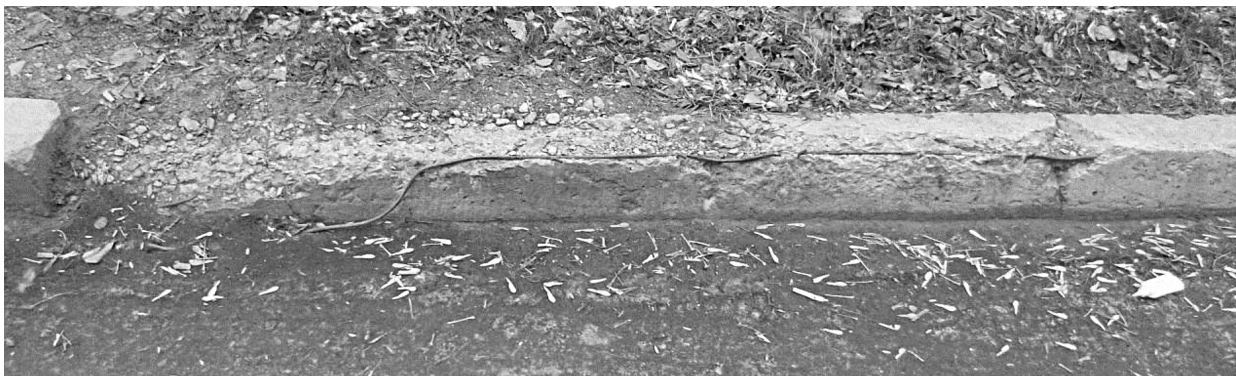
Рис. 5. Пример существенного разрушения левой части бортового камня (1280x391 пикселей)
