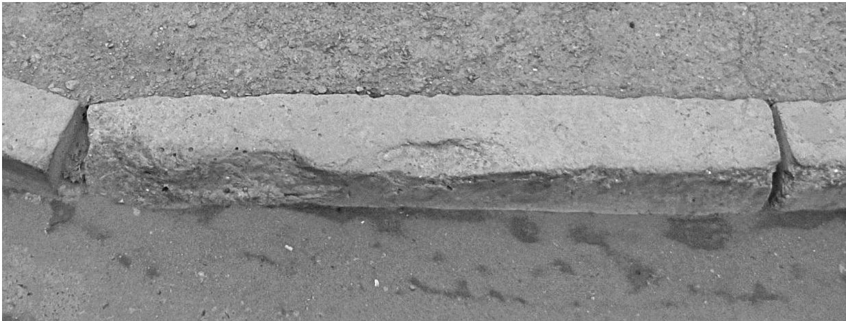
Рис. 4. Пример разрушения угловой части бортового камня (1280x713 пикселей)
