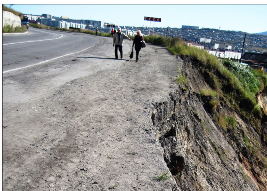
Рисунок 1. 2013 г. Активизация оползневых процессов.
