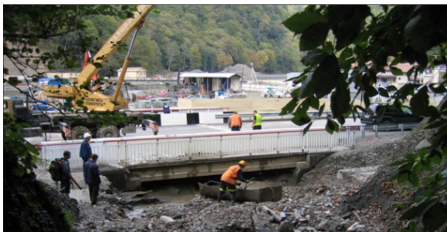
Рисунок 1. При сходе селевого потока по р. Сулимовская подмостовое пространство было заполнено селевым материалом. Фото Ю. Ефремова.
