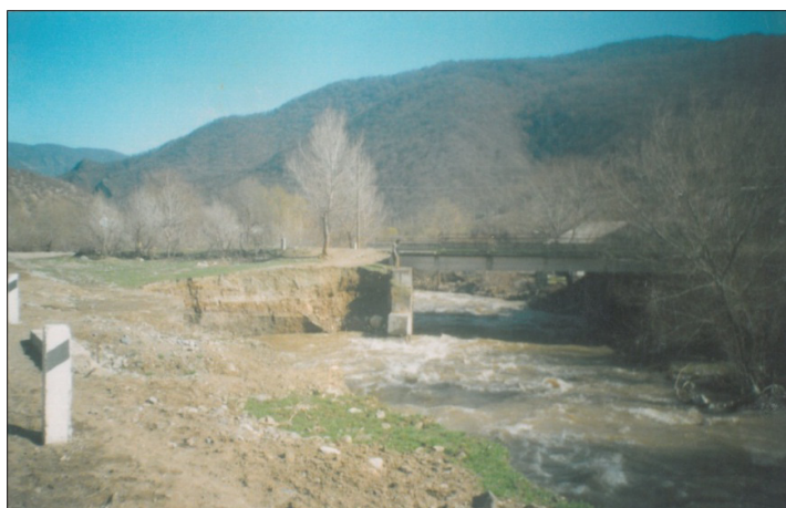
Рисунок 2. Фрагмент разрушения моста селевым потоком у села Овк.
