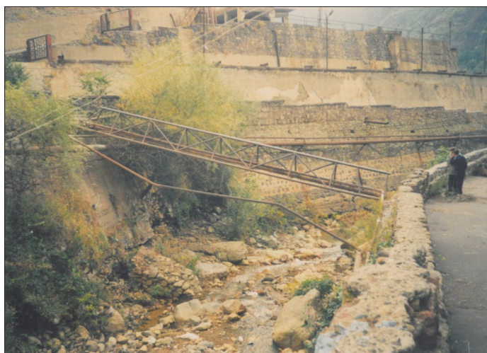
Рисунок 1. Разрушение селепровода и коммуникаций в г. Алаверди.
