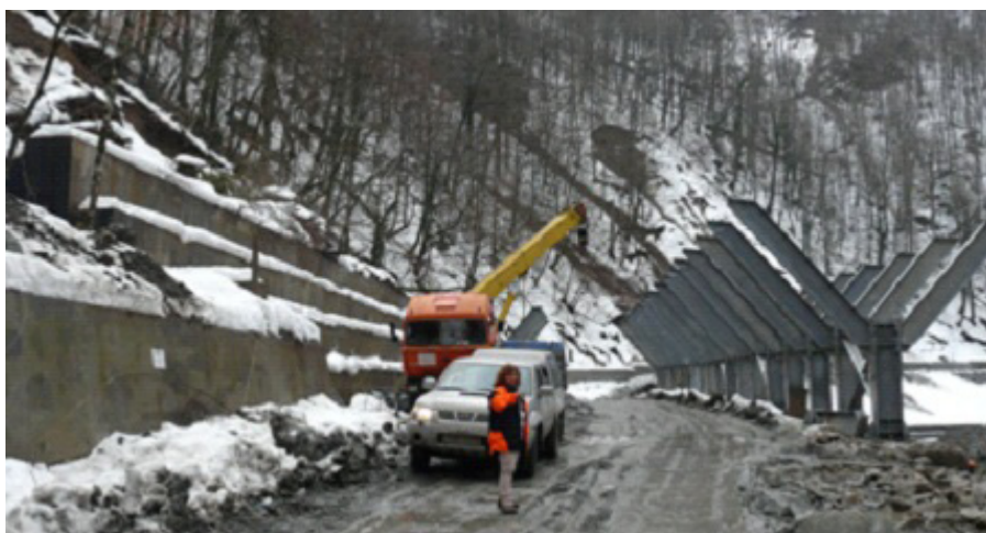
Рисунок 3. Строящаяся противоселевая галерея на дороге с. Эсто Садок – устье р. Пслух была засыпана селевыми отложениями.
