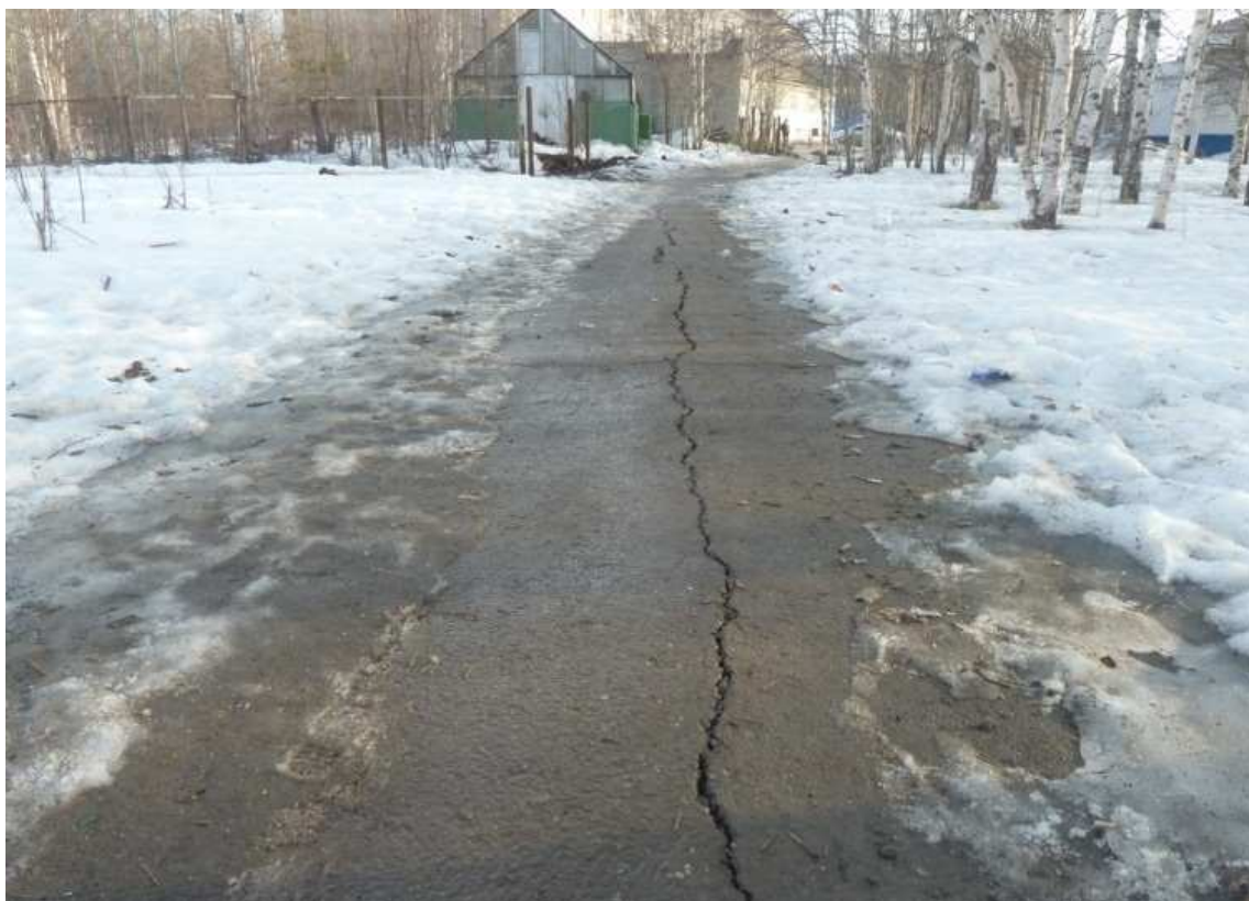
Рис. 2. Развитие морозобойных трещин в 7 микрорайоне (апрель 2012 г.)
