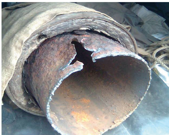
▲ Иркутск, ул. Чехова, состояние трубопровода «труба в трубе» после 7 лет эксплуатации (заменен на трубопровод в ППМ-изоляции)
