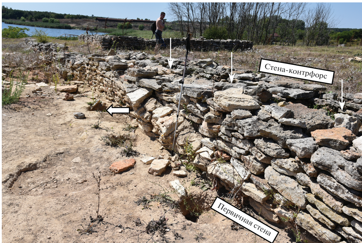
Рис. 9. Наклон и выдвигание длинной стены субмеридионального простирания к востоку в нижней своей части (показан толстой горизонтальной белой стрелкой). Важно отметить стену-контрфорс к западу от наклонной стены. Вертикальные белые стрелки показывают зазоры между стенами. Длина треновой палки 1.10 м. Вид на Ю—ЮЗ.
