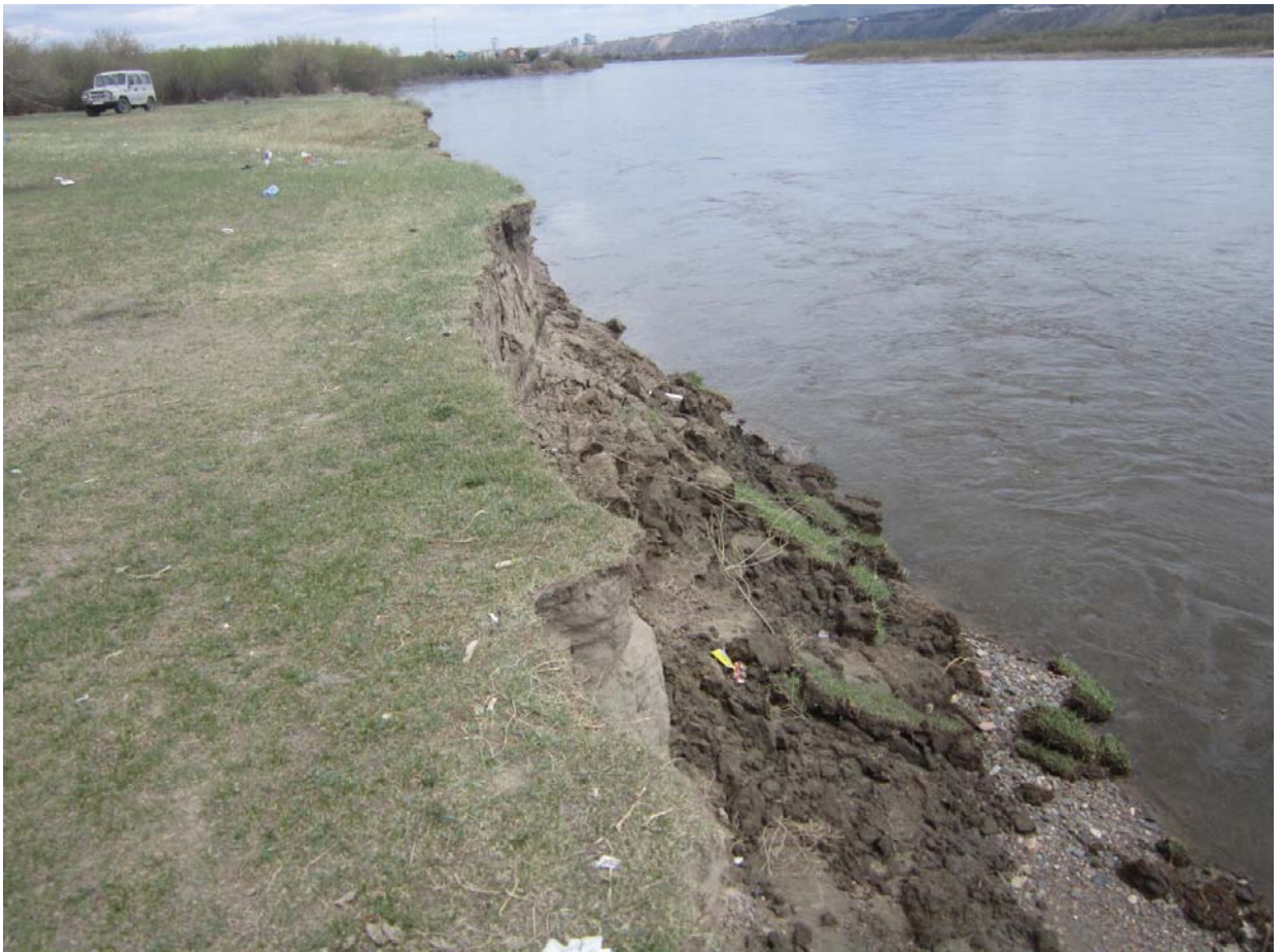
Рис. 1.2.2.2.2. Эрозионное разрушение берега на участке «Сужа»
