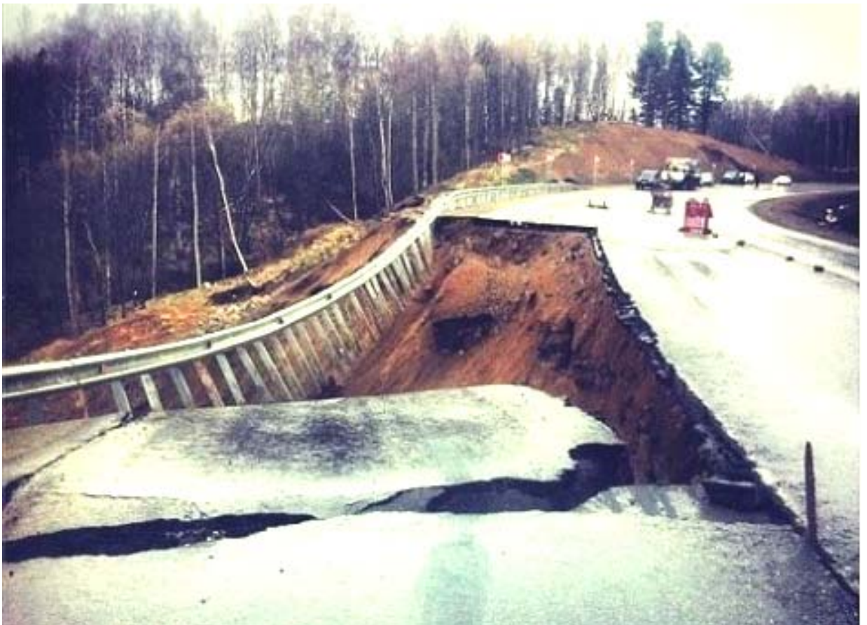
Рис. 1.2.2.2.3. Обрушение участка автодороги дороге М-55 «Байкал» 9 мая 2013 г.
