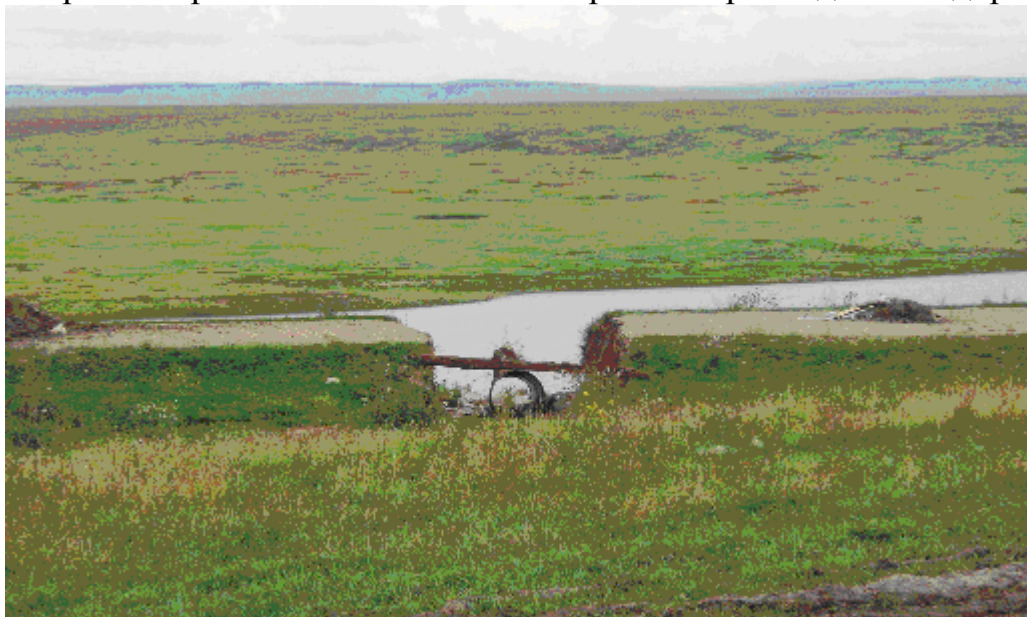
Рис. 7.2.4. Разрушенная автодорога Хадахан – Закулей (фото Козыревой Е.А., 2009)
