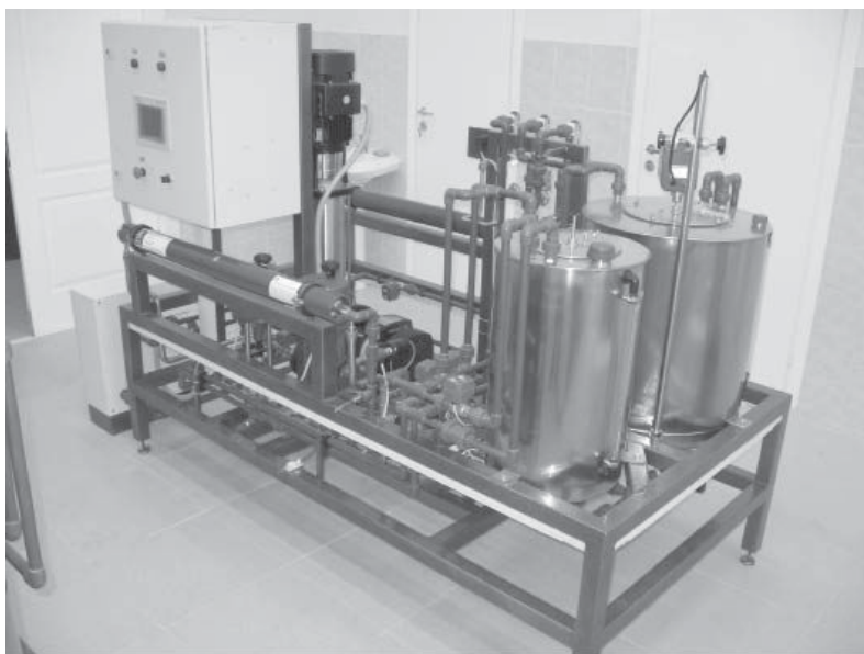
↑ Рис. 2. Установка очистки воды с помощью обратного осмоса.
