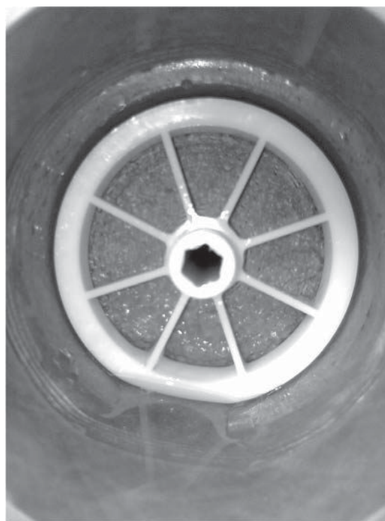
Рис. 6. Отложение осадка на торце обратноосмотического фильтроэлемента.
