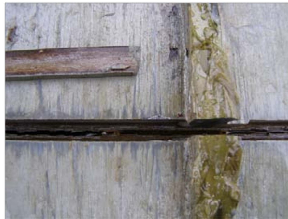
Рис. 3. Сквозная трещина и выпавший из дефекта фрагмент заполимеризовавшегося заполнителя после демонтажа муфт
