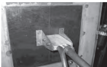
Рисунок 6 Вихревой охладитель, смонтированный на стенке электрошкафа
