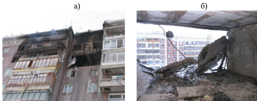
Рис. 1 Фрагмент фасада здания (а) и интерьера квартиры (б) после взрыва
