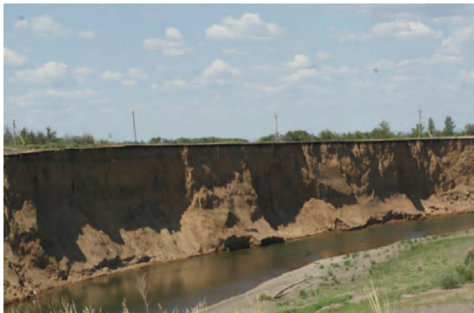
Рис. 4. Разрушение берега р. Сакмара у с. Желтое
