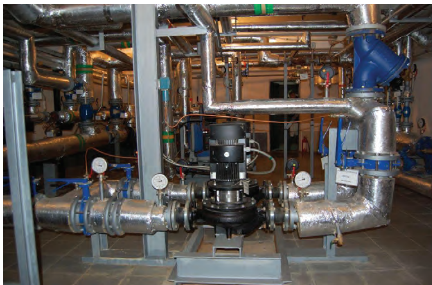
Рисунок 1-Центральный тепловой пункт. Саратов.
