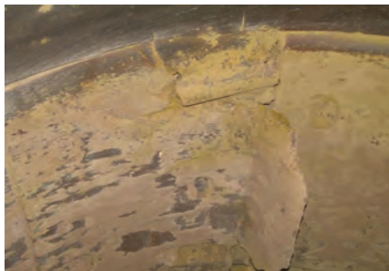
Рис. 3. Трещины корпуса рекуператора
