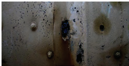
Рис. 2. Прогар корпуса рекуператора
