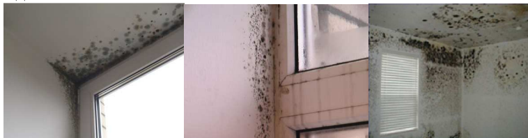
Рис. 1. Последствия нарушения процесса вентиляции в квартирах
