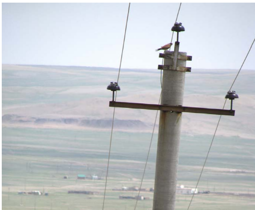
Рисунок 1. Опора ЛЭП 6-10,20 кВ
