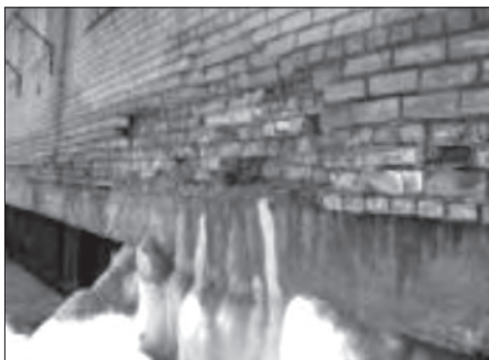
Рис. 2. Разрушение кирпичной кладки техногенной наледью.
