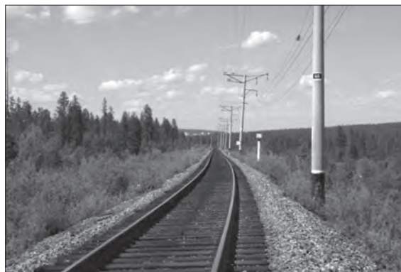
Рис. 7. Крен опор ЛЭП.
