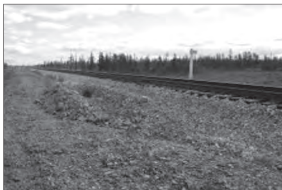
Рис. 3. Деформация земляного полотна. (174 км).
