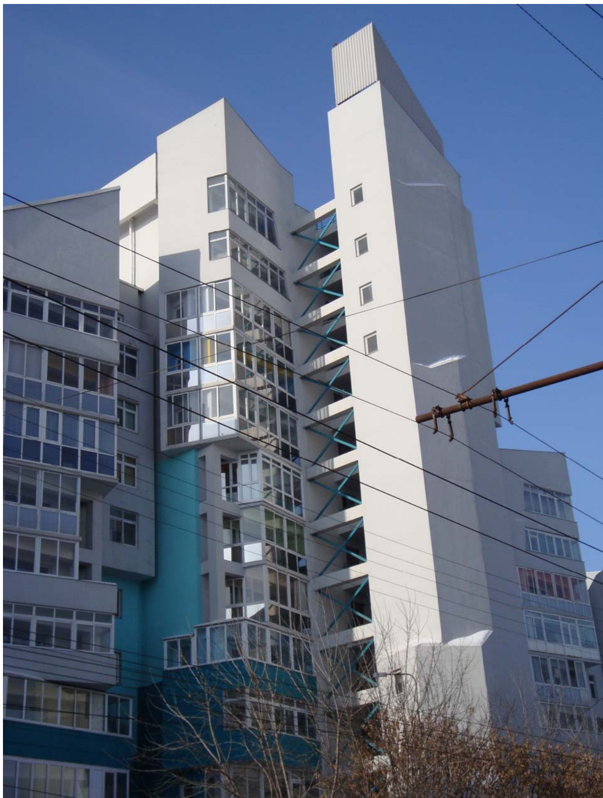
Рис. 22. Незадымляемая лестница на фасаде дома в районе остановки транспорта «Помяловского». Видны связи лестницы с домом, не обеспечивающие её сейсмостойкость
