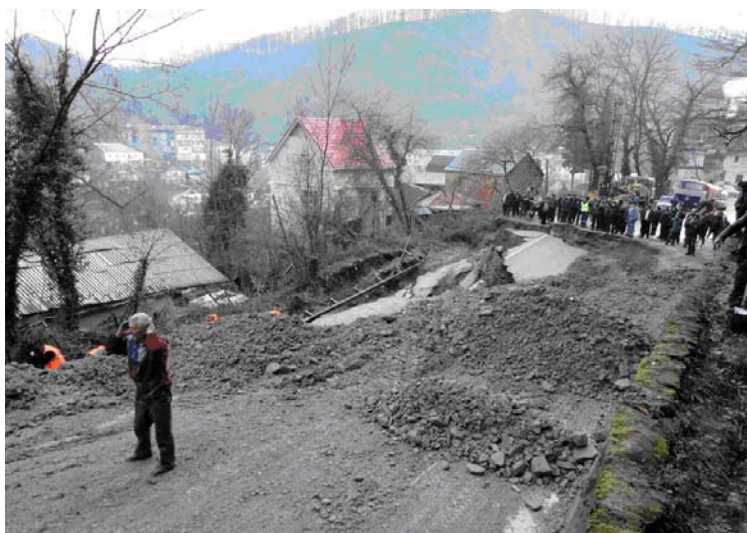
Рис. Разрушенный оползнем участок автомобильной дороги М-27 Джубга – Сочи, км 56+860
