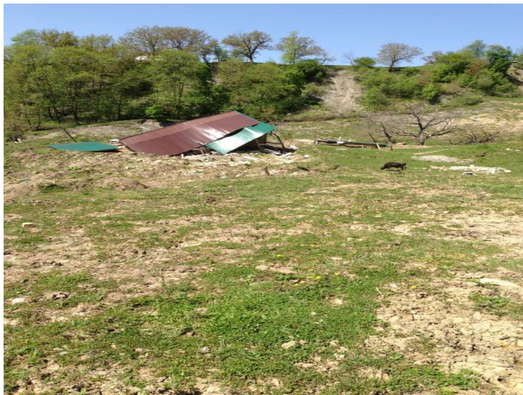
Рис. 2. Оползневые смещения на окраине с. Айти-Мохк
