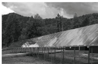
Энергоустановка на базе дизель-генератора и тонкопленочных фотоэлектрических модулей в пос. Яйлю, Республика Алтай
