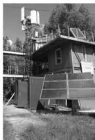
Экспериментальный образец гибридной солнечно-ветровой энергоустановки мощностью 3 кВт в ОНБТ РАН
