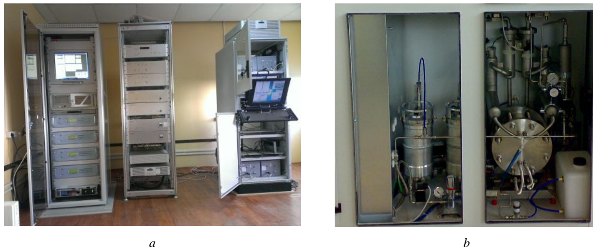
Рис. 5 – Оборудование водородного модуля: а – система мониторинга и управления СМУ с программируемым логическим контроллером ПЛК; б – модуль компрессии МК и модуль электролизера МЭ
