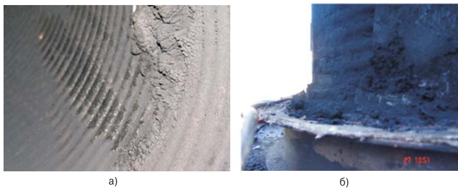
Рис. 5. Состояние стенок змеевикового теплообменника: а, б – внутренняя и наружная поверхности змеевика соответственно
