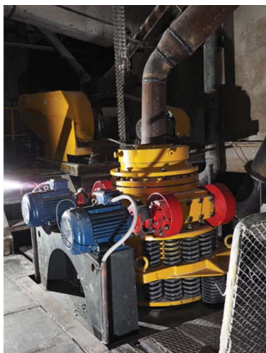
Рис. 4. Дробилка ВКД-300 в цехе дробления электрокорунда ОАО "РУСАЛ Бокситогорск"
