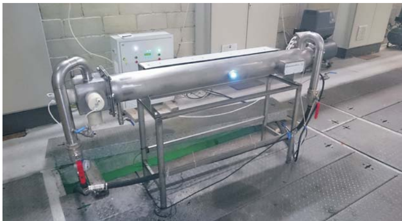
Рис. 1. Установка УОВ-СВ-5, смонтированная по месту проведения испытаний
