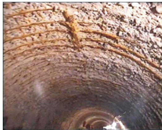
Рис. 1. Газовая коррозия железобетонного трубопровода, обнажение арматуры
