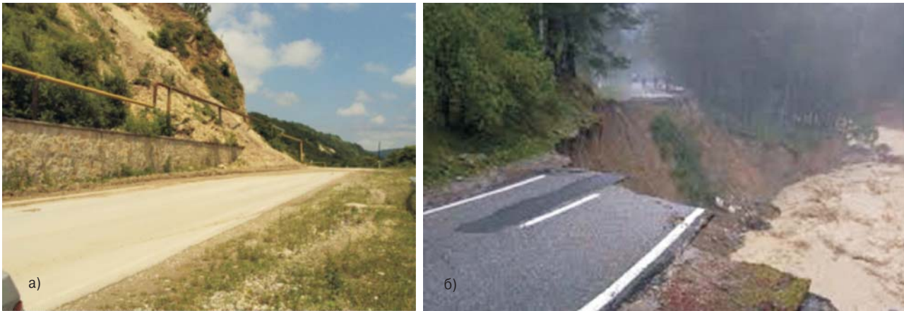
Рис. 1. Обрушение откоса по горной дороге в Приэльбрусье КБР (а) и размыв берега реки по горной дороге в Приэльбрусье КБР (б)
