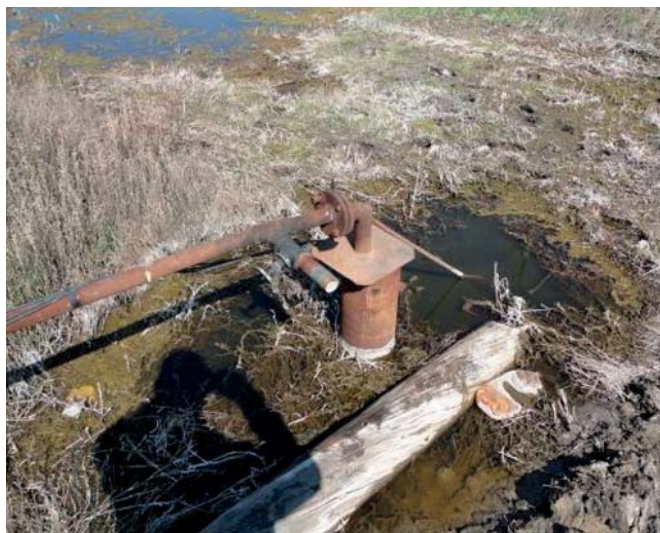
Водозаборная скважина № 51-380. Павильон отсутствует, скважина не оборудована системой приборов, позволяющих регистрировать дебит и уровень. Территория первого пояса зоны санитарной охраны (30 м) водозаборной скважины не спланирована с учетом отвода поверхностного стока за пределы ее границ в водоотводящие каналы, отсутствует ограждение первой зоны санитарной охраны радиусом 30 м от устья скважины. Первая зона санитарной охраны повреждена
