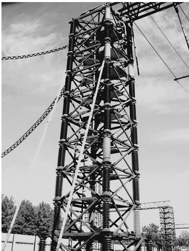
Рис. 5. Общий вид созданной и установленной на существующей изоляционной опоре нагрузочной емкости C_n \approx 13.3 нФ на номинальное импульсное напряжение 3 МВ, использованной в разрядной цепи г.к.и.н.
