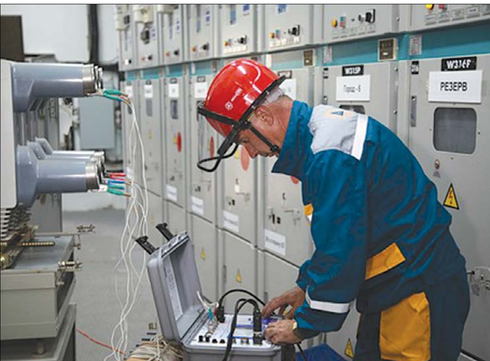
Энергетики ОАО «МРСК Центра» — «Курскэнерго» осваивают новый диагностический прибор ПКВ/М7
