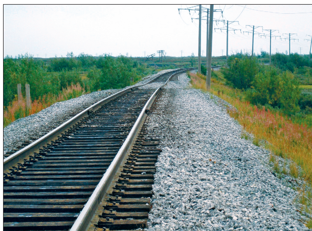
Рис. 1. Участок железнодорожной линии с осадками насыпи на линии Чум–Лабытнанги.
