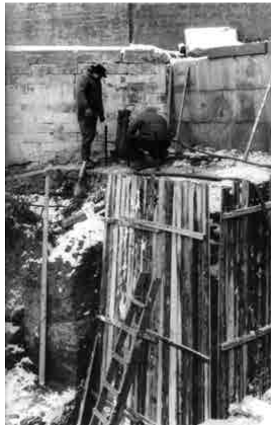
Рис. 6. Инъектирование грунтов культурного слоя на территории музея «Палаты бояр Романовых» (ул. Варварка, д. 10)
