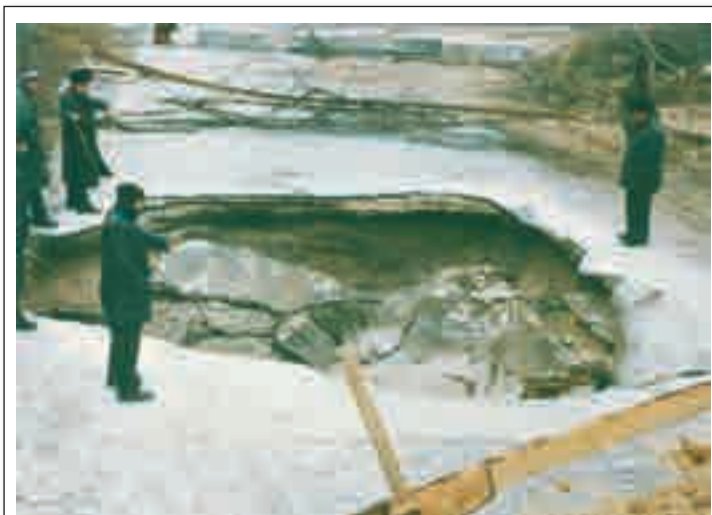
Рис. 1. Карстово-суффозионный провал, образовавшийся в декабре 1996 года в промышленной зоне г. Дзержинска Нижегородской области в результате сброса воды в песчаные грунты
