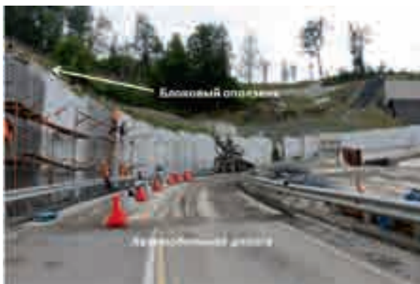
Рис. 2. Автомобильная дорога, ведущая к горнолыжному комплексу «Роза Хутор», проложенная в выемке и пересекающая среднюю часть блокового оползня (ЛТС типа I-A)
