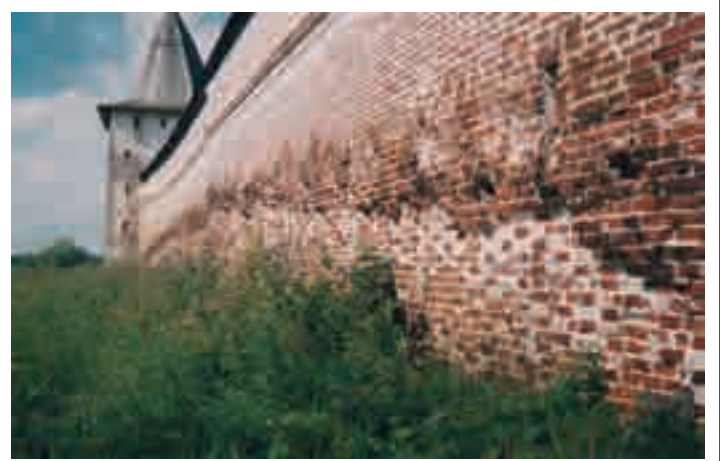
Рис. 1. Криогенное выветривание кладки цоколя крепостной стены
