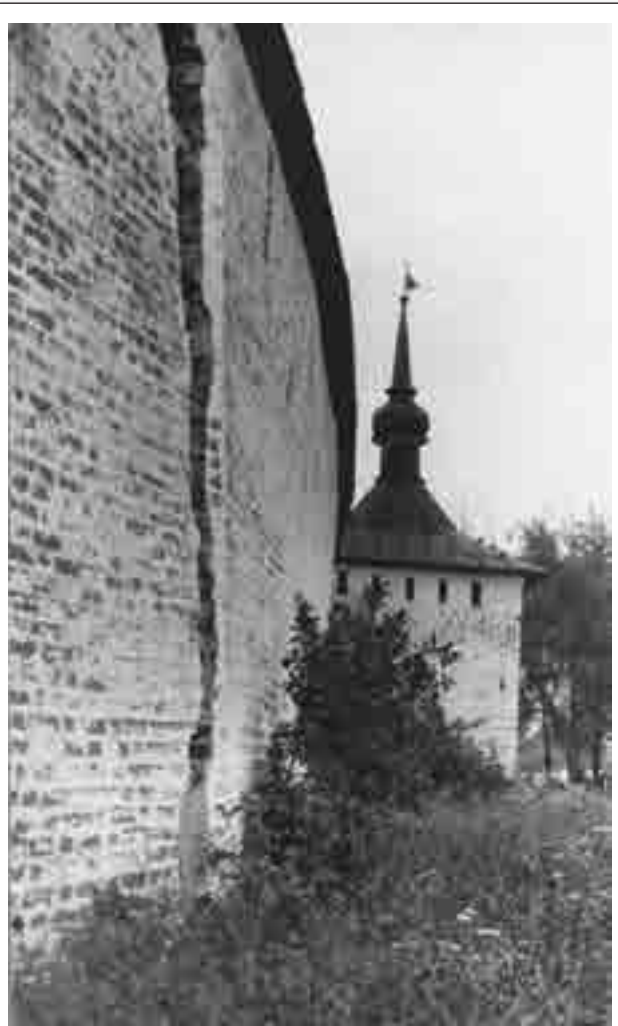
Рис. 3. Изгиб крепостной стены и образование трещины в результате температурных деформаций при ее нагревании
