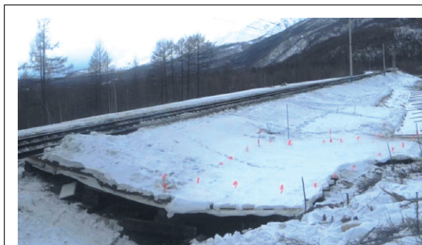
Рис. 15. Солнцезащитный навес над обочиной, откосом насыпи и бермой (1685 км ВСЖД, март 2015 г.)
