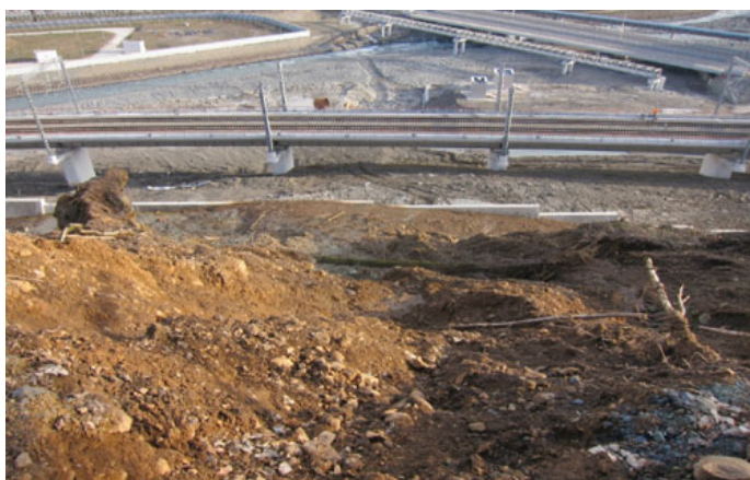
Рис. 2. Переваливание оползневых масс через подпорную стену (фото М.Л. Васильева, ОАО «Мосгипротранс»)
