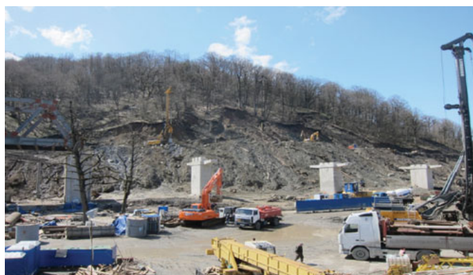
Рис. 1. Активизация оползневых процессов при строительстве дороги, ведущей к спортивно-оздоровительному комплексу «Горная карусель» (фото М.Л. Васильева, ОАО «Мосгипротранс»)
