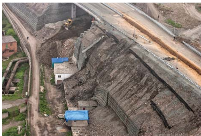
Рис. 6. Центральная часть оползня с наибольшей степенью деформаций грунта на участке автотрассы в районе бухты Тихая (фото А. Хитрова)
