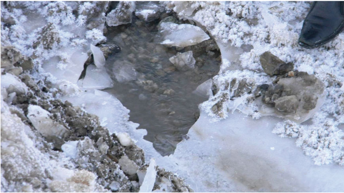
Рис. 8. Водоприток по водоотводной канаве 15.01.2011 г. при температуре наружного воздуха минус 40 °С
