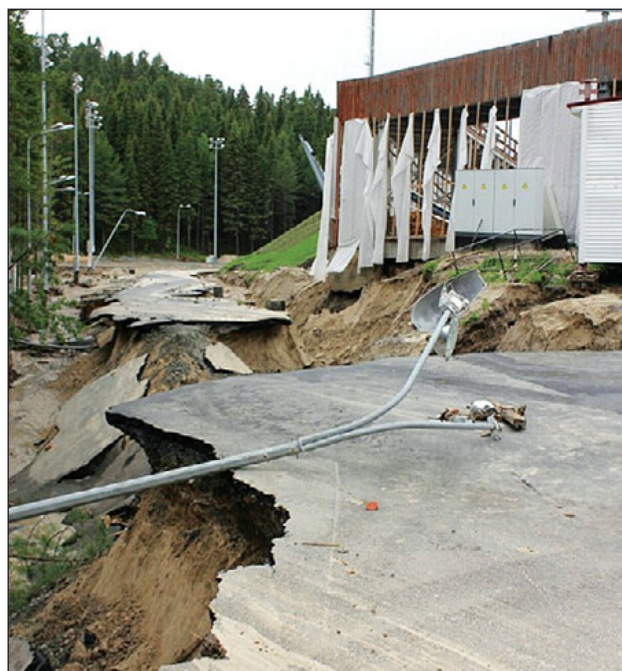
Рис. 2. Разрушения на биатлонной трассе (вид на трибуны)
