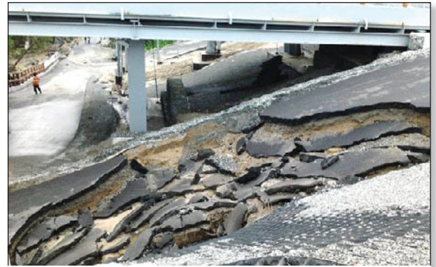
Рис. 3. Разрушения на скоростном спуске биатлонной трассы
