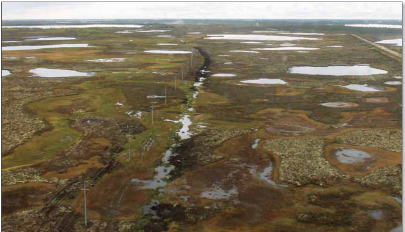
Рис. 5. Подтопление трассы «горячего» трубопровода при ее прохождении через массив многолетнемерзлых выпуклых бугров пучения (пальза) в лесотундровой зоне Западной Сибири (Пур-Тазовское междуречье, близ р. Туймылькы (фото из архива ОАО «ВНИИСТ»))
