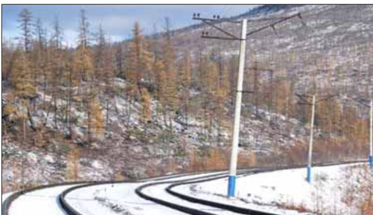
Рис. 2. Деформации пути на 1834 км ВСЖД (08.10.2010 г.)
