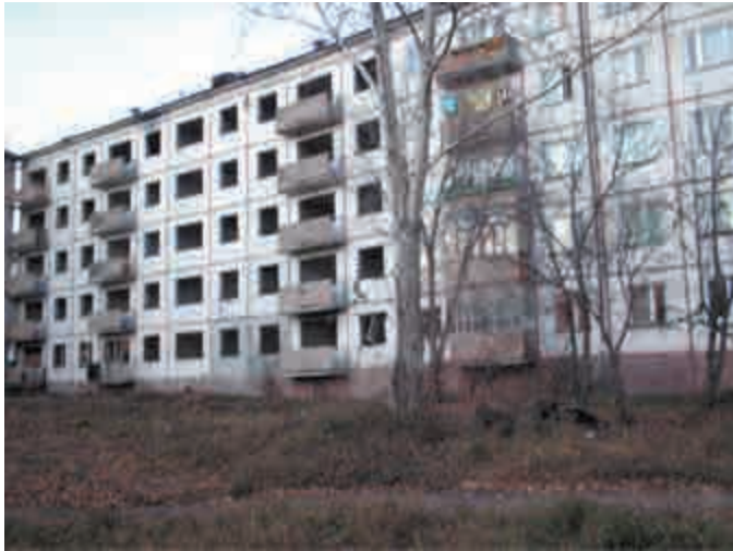
Рис. 1. Аварийное пятиэтажное здание на бульваре Рябикова (г. Иркутск)
