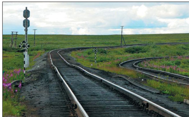
Рис. 22. Нарушения железнодорожного полотна из-за пучения грунтов на перегоне Хановой — Мульда летом 2006 г. (фото И. Бакирова)
