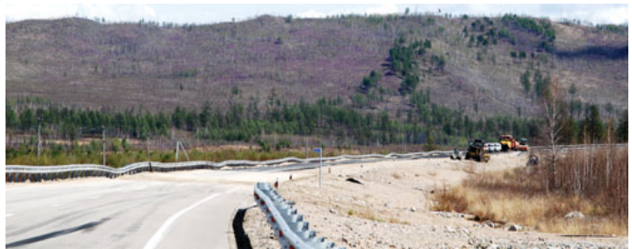
Рис. 1. Состояние автодороги «Амур» на участке «км 531» (21 мая 2013 г.)
