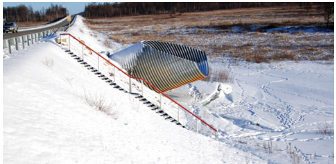
Рис. 2. Деформированная водопропускная труба на участке «км 526» автодороги «Амур» (25 декабря 2012 г.)
