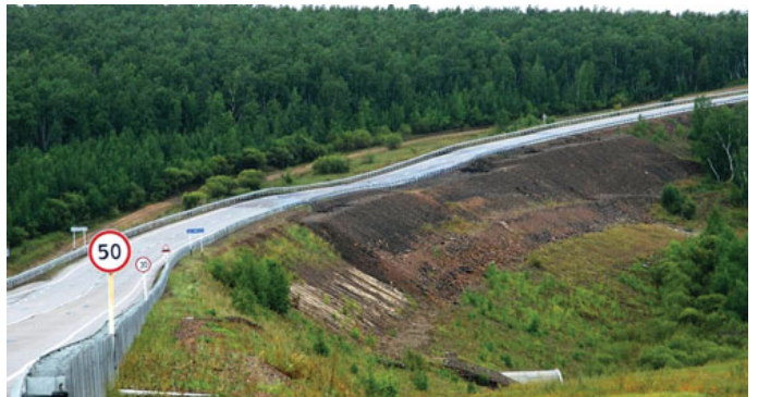
Рис. 4. Состояние автодороги «Амур» на переходе через ручей Чичон (на участке «км 247», 16 августа 2012 г.)
