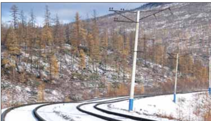
Рис. 2. Деформации пути на 1834 км ВСЖД (08.10.2010 г.)
