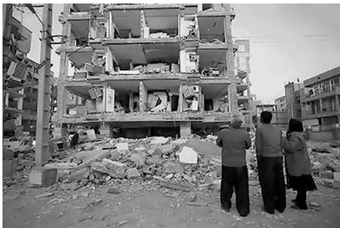
Последствия землетрясения в Иране 12 ноября 2017г. (магнитуда M = 7,4 ).
