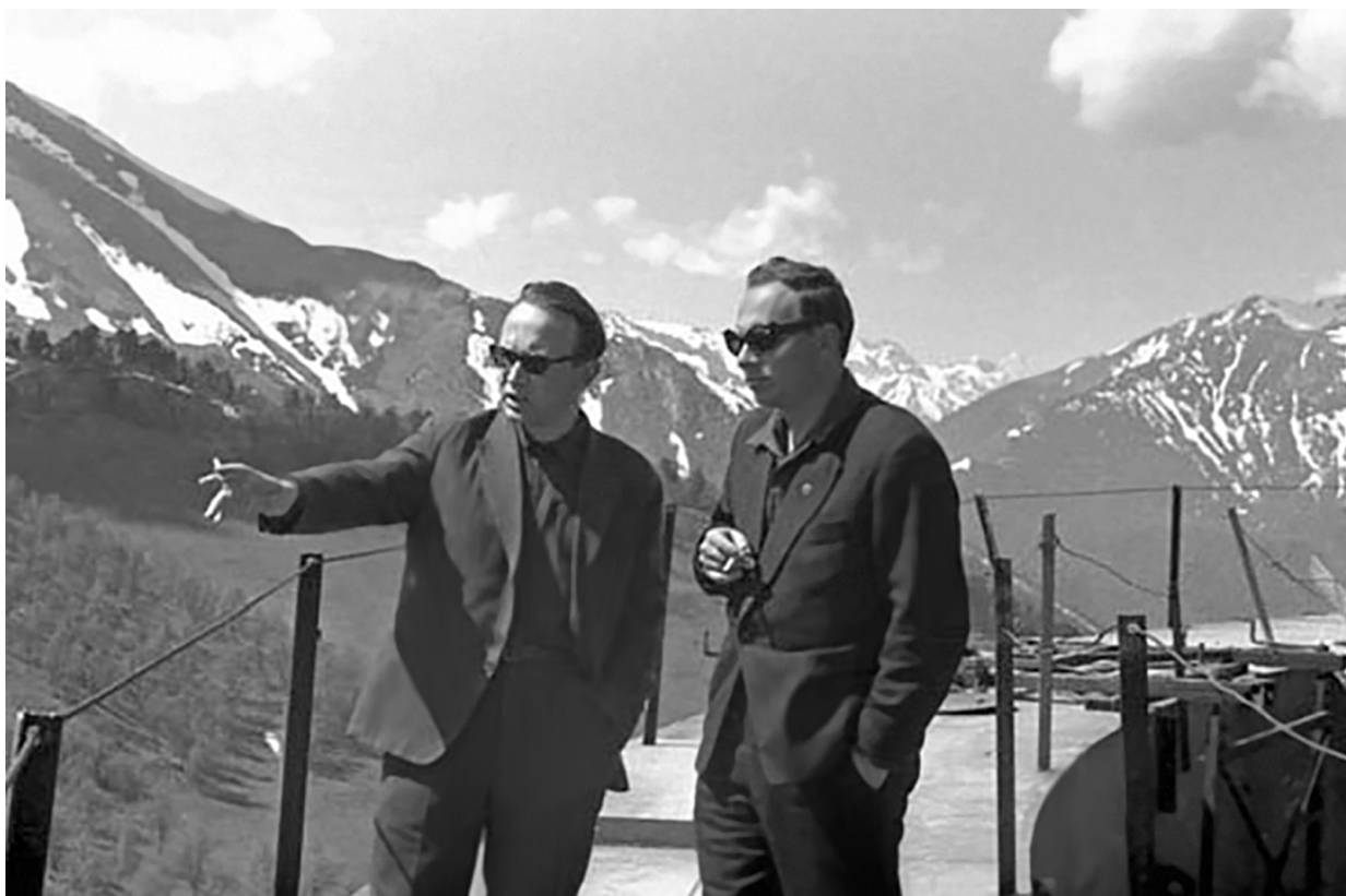
И.М. Копылов и его заместитель по научной работе С.В. Рублёв на строительстве башни БТА. 1968 г.
